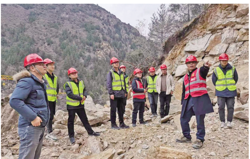
业主、设计、监理及施工单位在神山隧道出口的高边坡现场进行现场办公，已确定高边坡爆破施工方案。
